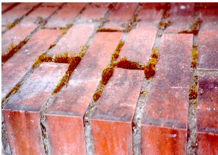
Obr. 7: Osídlení vápnitých spár koruny zdi akrokarpními mechy.
