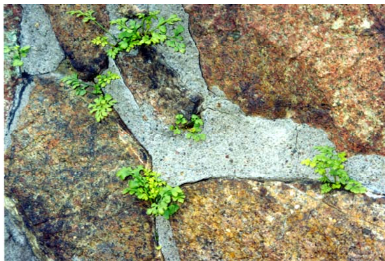
Obr. 5: Počáteční známky degradace zdi vlivem klimatických faktorů a primární osídlení vápnomilným druhem Asplenium ruta-muraria .
